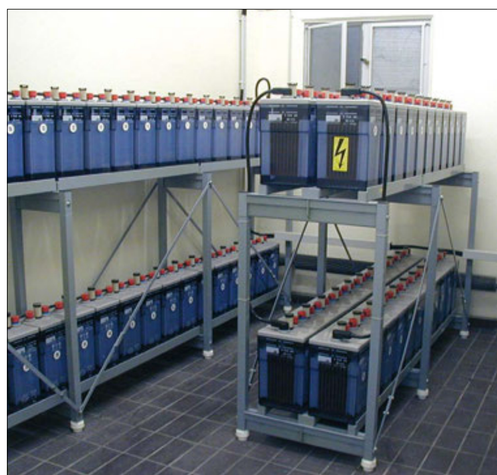
Abschalten nicht möglich, führt immer Spannung
